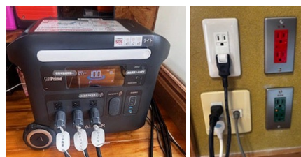
ポータブル電源(プラグに行き先の札)と、停電時に差し替える非常用コンセント
